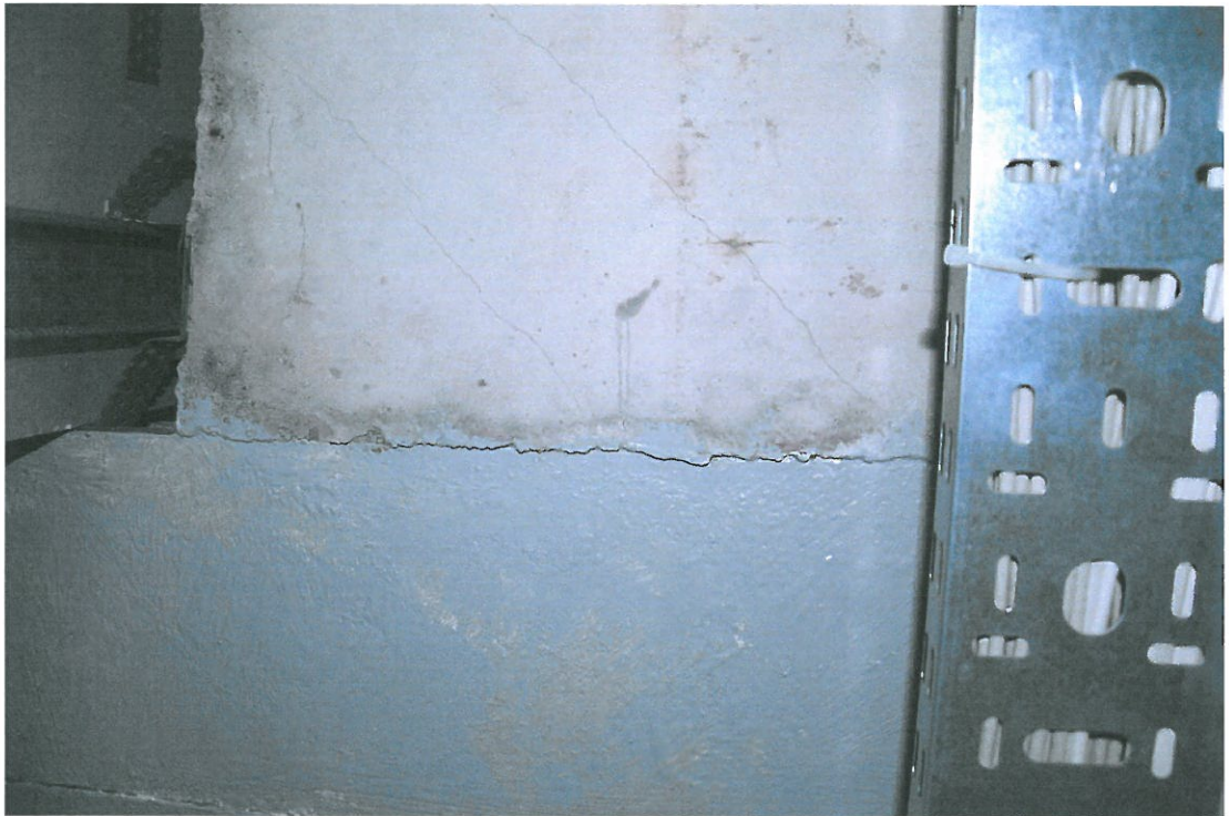
Fot 2 Rysy w narożniku płyty
