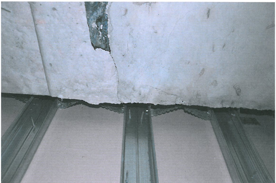
Fot 3 Rysy podłużne oraz lokalne odpryski betonu
